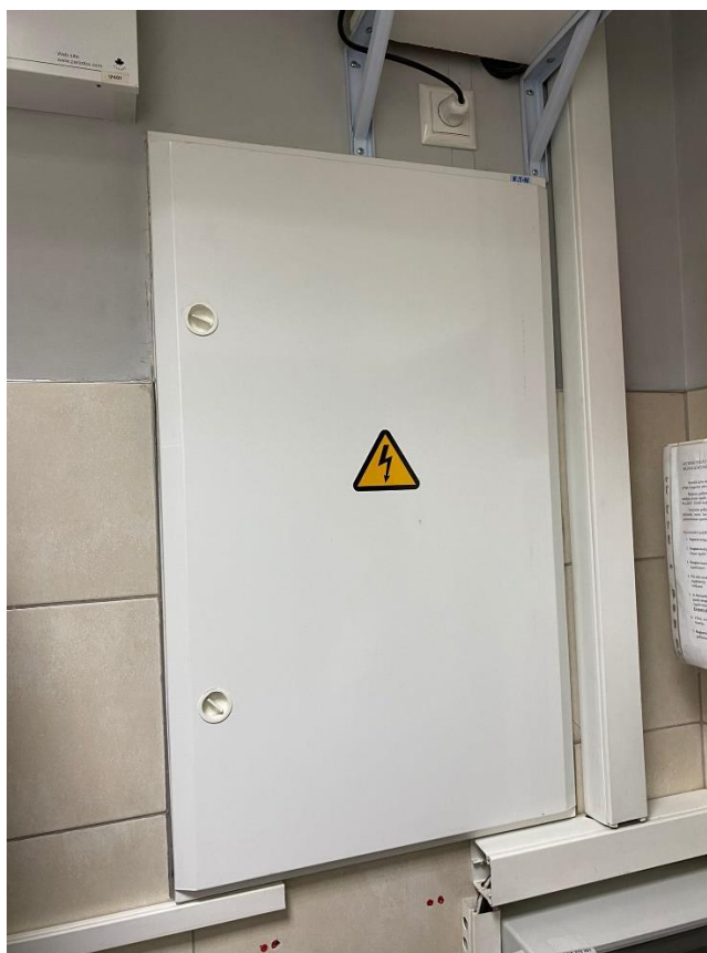
13.attēls. Galvenā elektrības atslēgšanas vieta Objektam
