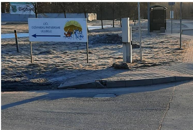
Attēls 3 "Deformēta betona apmale pagrieziena rādiusā"
