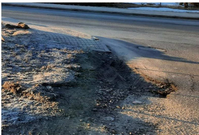
Attēls 4 "Bedre asfaltbetona segumā un izbraukāta ceļa nomale"
